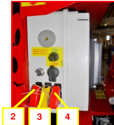
Afbeelding 5: linkerzijde van de schakelkast.
