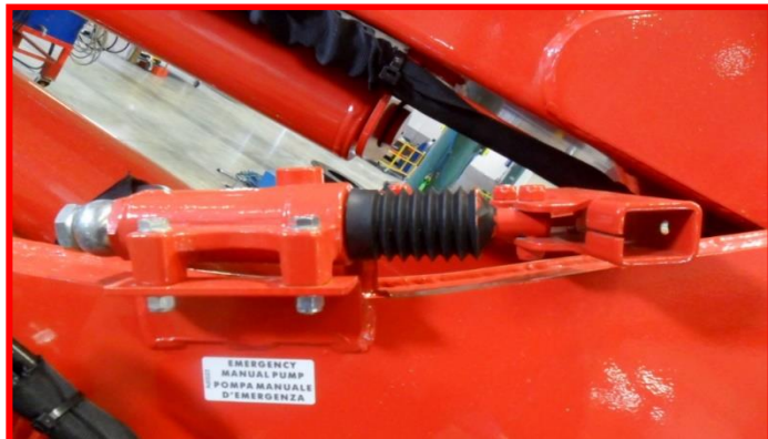
Afbeelding 60: inbrengpunt van de handpomp.
