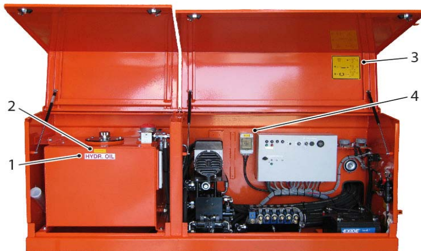
Compartiment d'huile hydraulique et compartiment des soupapes/électricité
